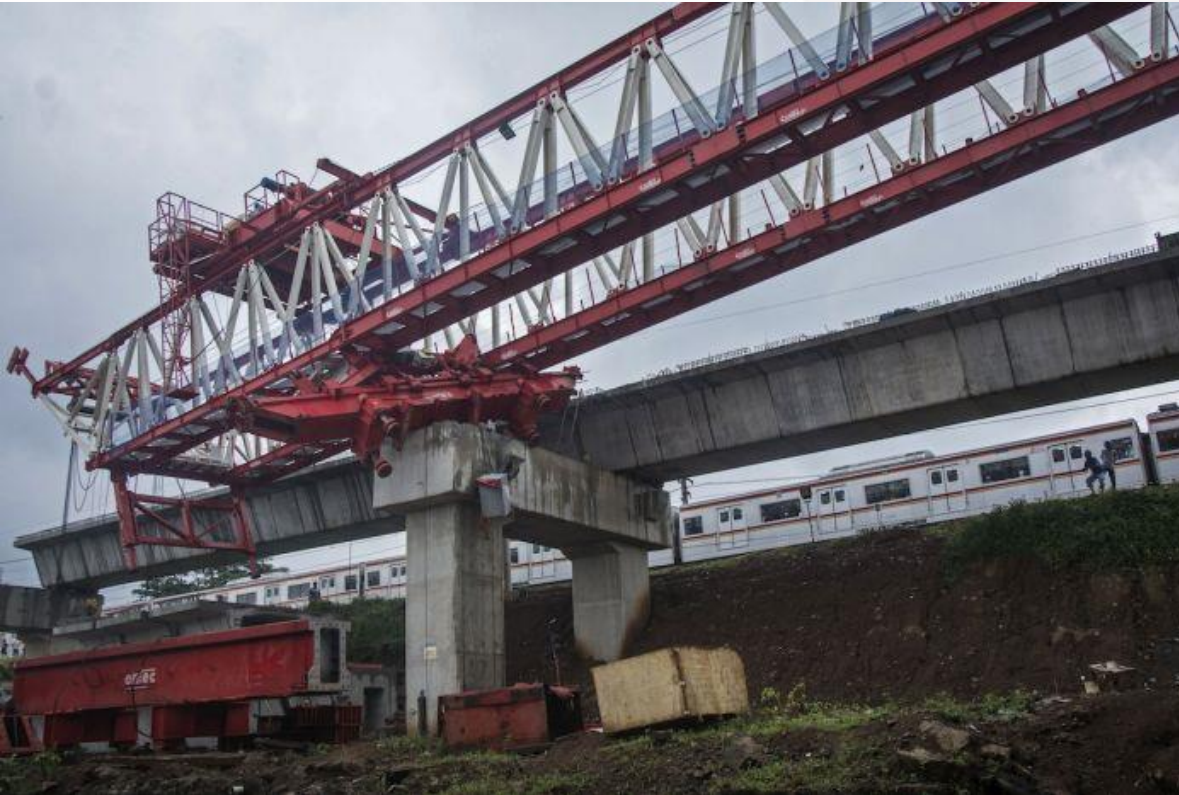
Crane Pengangkut Beton Proyek DDT di Matraman, Jakarta Timur Roboh, Minggu (4/2/2018).
