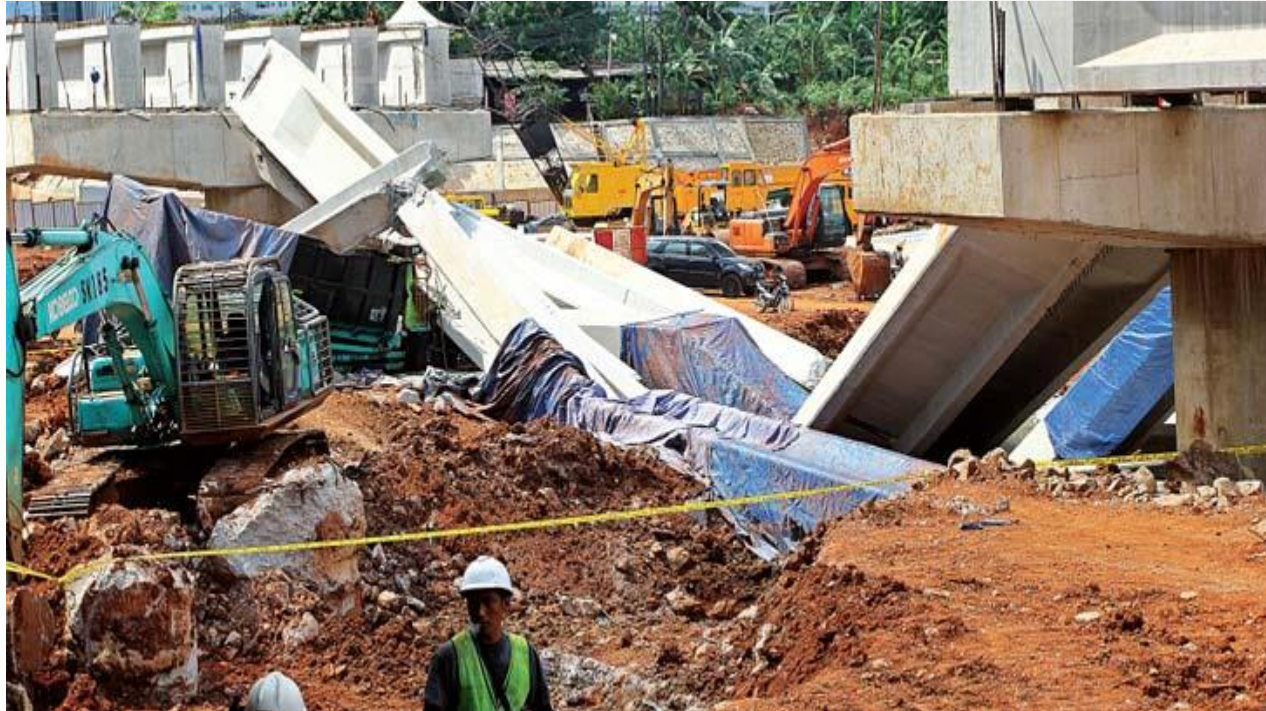
Beton girder proyek Jalan Tol Depok-Antasari, Jakarta Selatan roboh, Selasa (2/1/2018), pukul 10.00 WIB.
